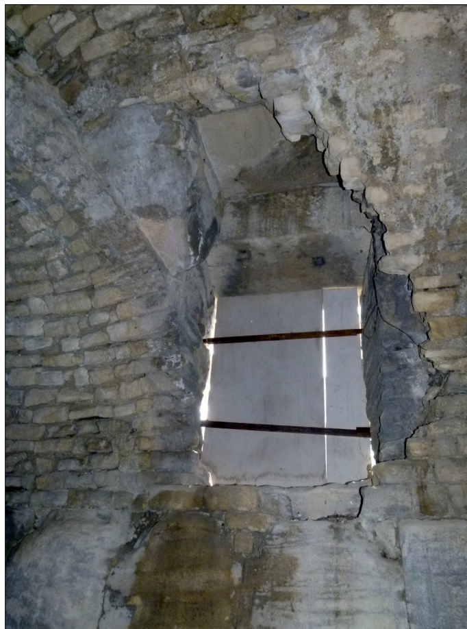
Fig. 9 – Porte supérieure du mur du podium donnant au sous-sol dans la voûte de la galerie du podium . La voûte a été percée assez grossièrement.
