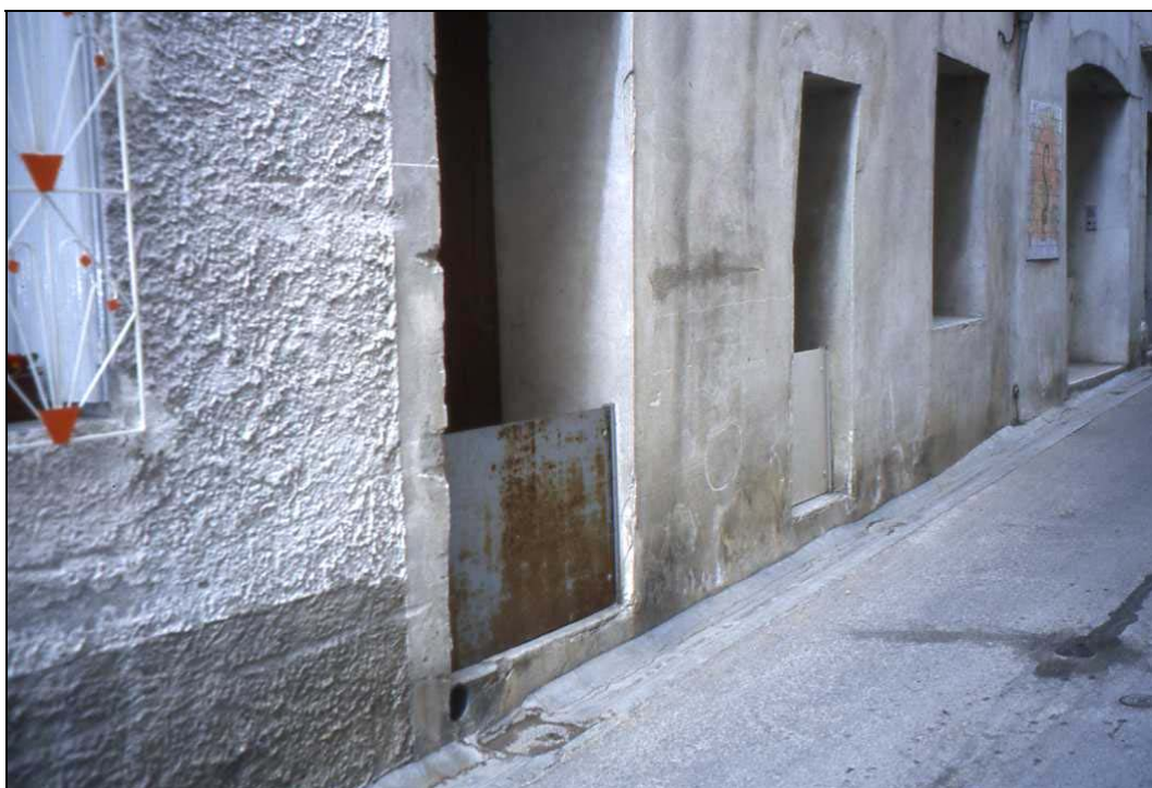
Photo 42 - Batardeaux à Quissac (Gard).
