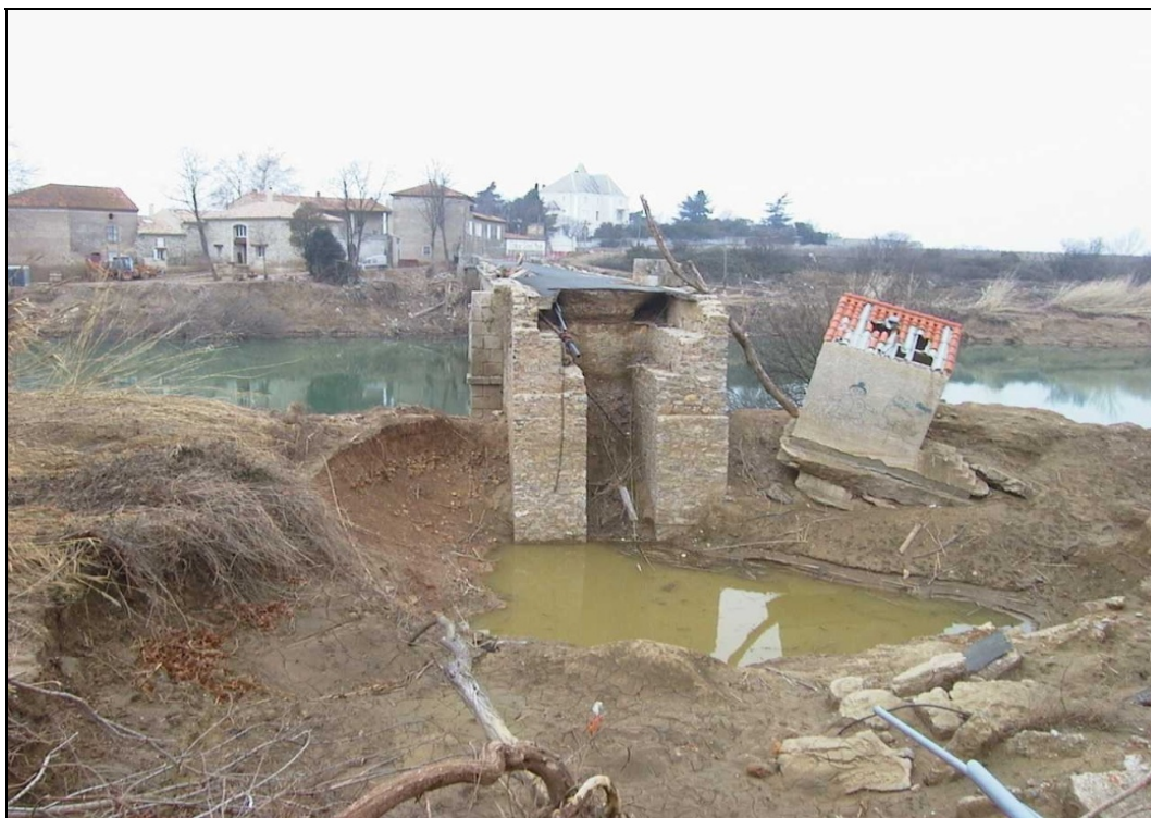
Photo 73 - Pont de Luc-sur-Orbieu (Aude) détruit par la crue de novembre 1999.
