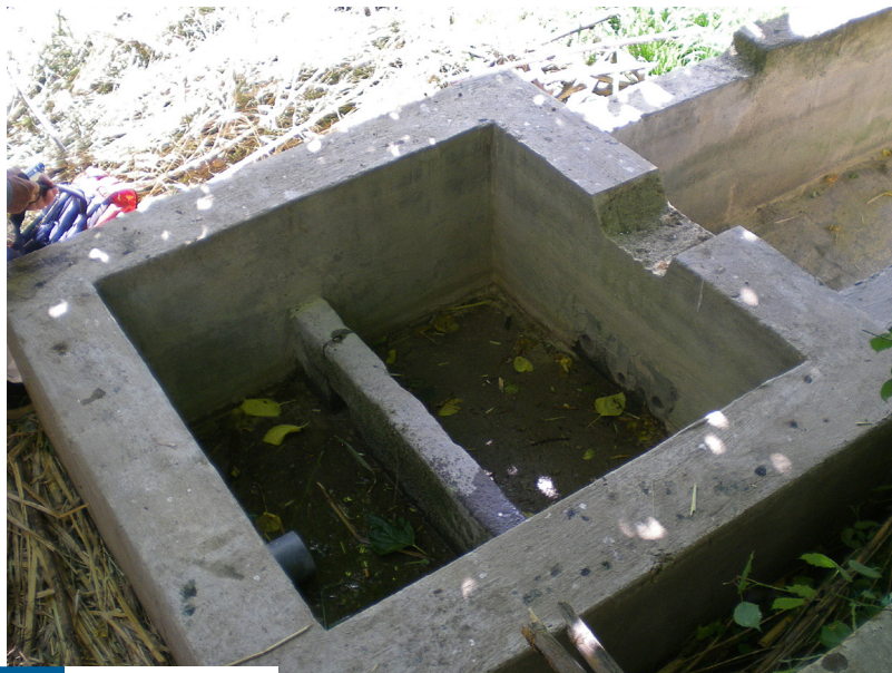
Fig.59 Bassin de régulation
