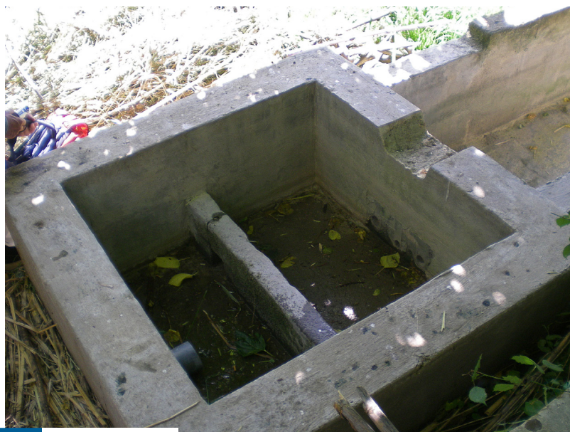
Fig.59 Bassin de régulation
