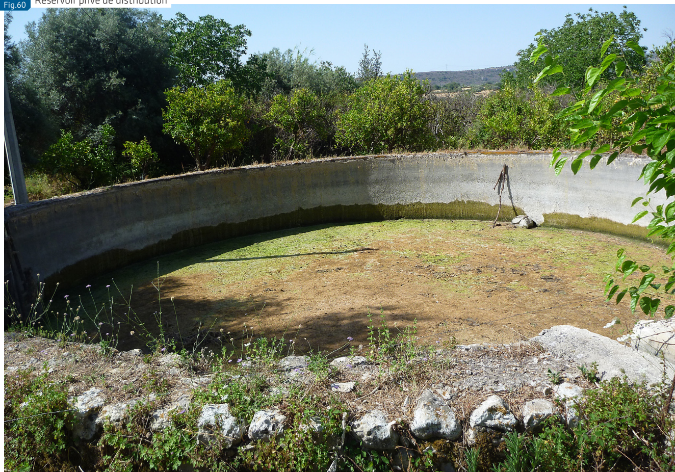
Fig.60 Réservoir privé de distribution
