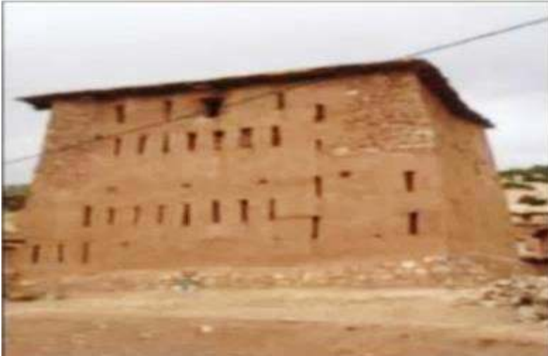
Figure 9 : Greniers dont la restauration pose des problèmes entre fonctions touristiques et sauvegarde collective des biens précieux de la communauté (Maroc)
